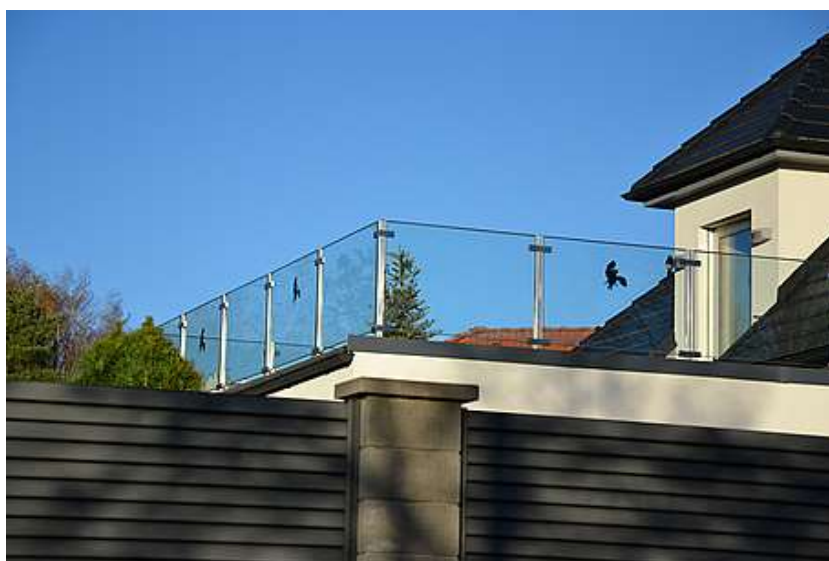
Obr. 37: Nedostatečně zabezpečené skleněné zábradlí.
